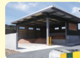
あわら温泉美松 メーカー：KWB （オーストラリア） 製品名：パワーファイア 出力：600kW （300kW×2台）
